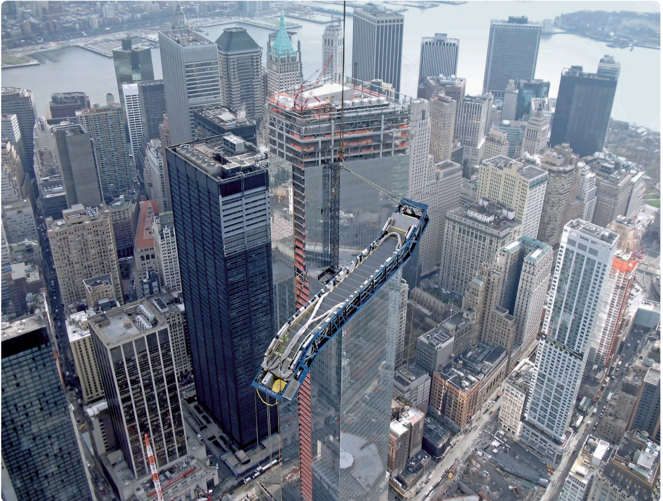
Fahrtreppe auf dem Weg zum Einbau ins One World Trade Center, New York (Quelle: thyssenkrupp)
